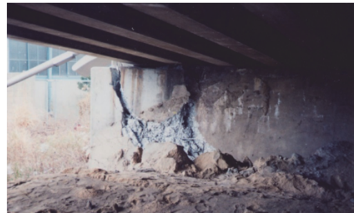
写真-1 側方流動による橋台の損傷事例（東魚崎大橋・1995年兵庫県南部地震）
