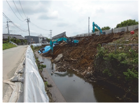
写真-4 護岸の水平移動を伴う盛土のすべり崩壊
