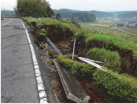
写真-6 路肩の埋設導水管の抜け・浸水
