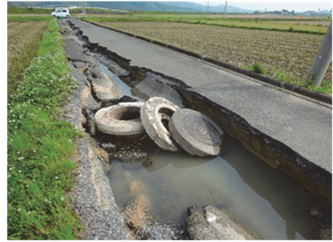
写真-7 埋設管の被害による道路陥没
