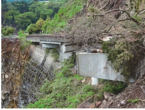
写真-2 斜面崩落が直撃した戸下大橋
