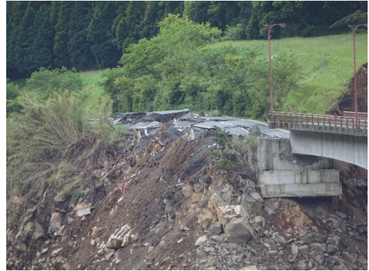
写真-1 橋台の沈下と取付け盛土の崩壊
