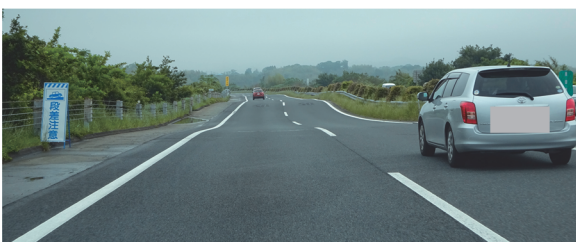
写真-3 路面の波打ちの状況
