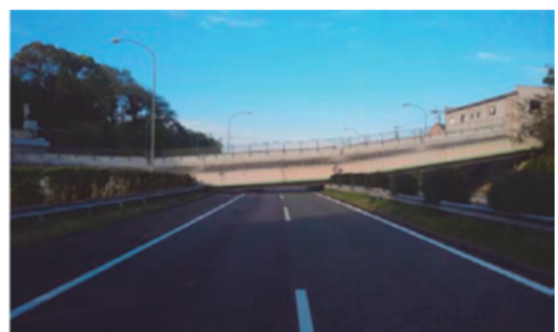
写真-5 掘割部の跨道橋の落橋：NEXCO西日本による
