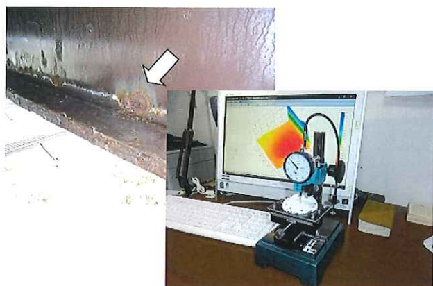
写真-3 こぶ状さび外観と型取りによる腐食量計測状況
