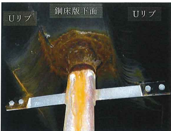
写真-4 排水柵（鋼床版下面）の損傷
