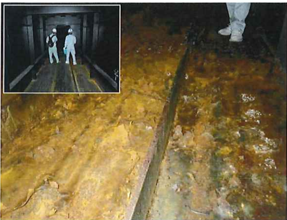
写真-5 箱桁内部の損傷（左上は健全部）
