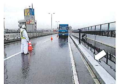
写真-7 鋼製排水溝
