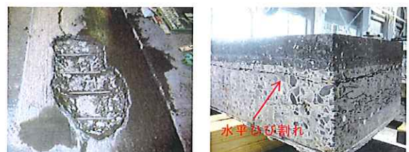
写真-2 鋼板補強床版の内部変状
