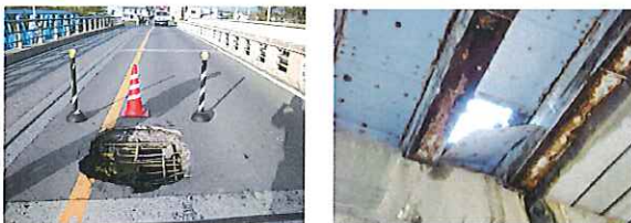
写真-1 床版抜け落ちの事例
