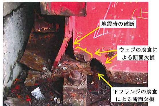
写真-1 鋼橋桁端部の地震時の破断事例 4)
