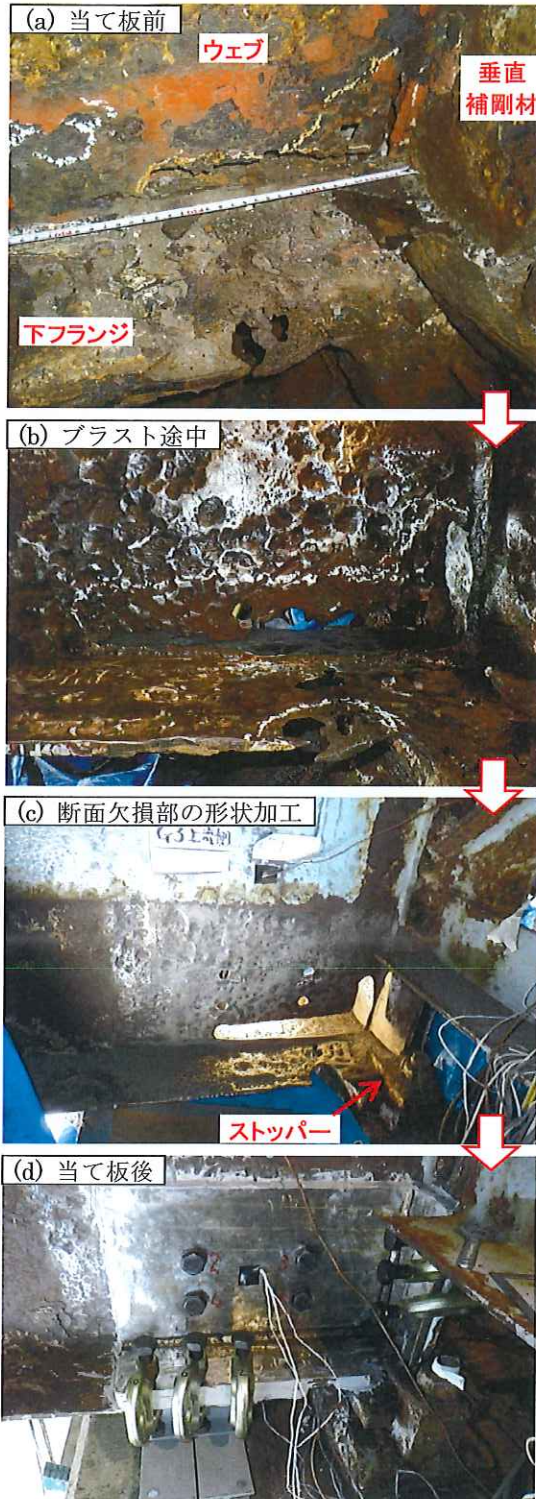
写真-3 当て板箇所断面欠損と当て板補強の施工状況 (いずれも上流側から撮影)
