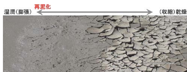
写真-4 再泥化状況
