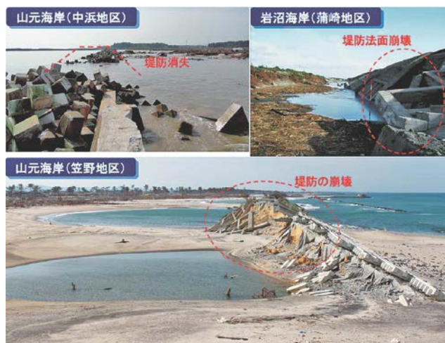
写真-2 海岸堤防被災状況
