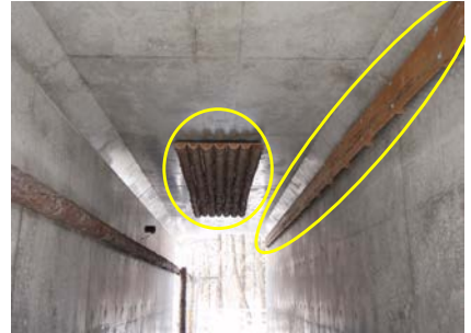
BC内にバットボックスを設置したもの (帯広広尾道路)
