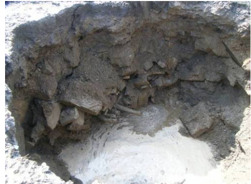
写真-1 掘削時に遭遇した廃棄物
