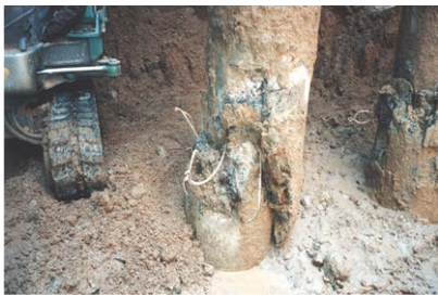
c) PHC杭のせん断破壊
