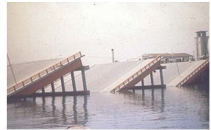
b) パイルベント橋脚の被災
