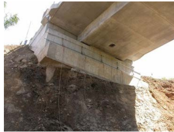
d) 斜面崩壊による杭頭露出
