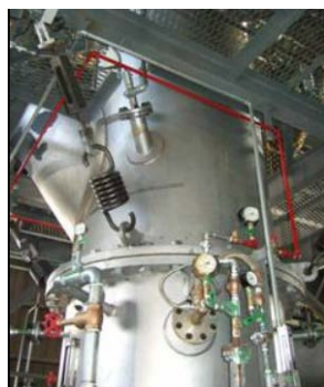
(加圧流動炉本体)
