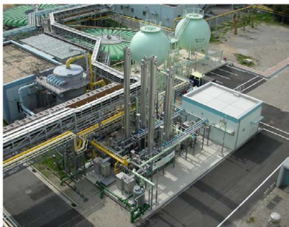
写真-2 バイオ天然ガス化装置（実施設）の状況 （神戸市東灘処理場）
