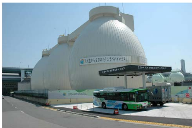
写真-3 こうべバイオガスステーション
