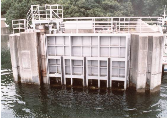
写真-4 アルミニウム合金製水門
