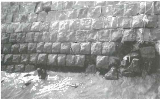
写真-7 接合部の劣化により崩壊した護岸
