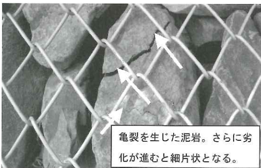
写真-3 劣化を生じた割ぐり石
