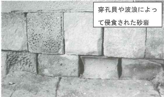
写真-6 歴史的土木構造物に見られた石材の劣化
