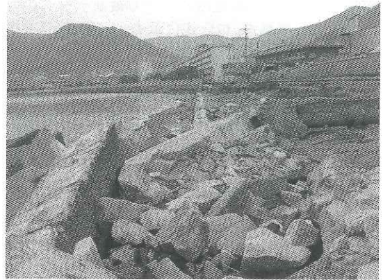
写真-1 台風で崩壊した堤防
