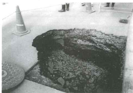
写真-1 下水道管渠腐食による大規模な陥没
