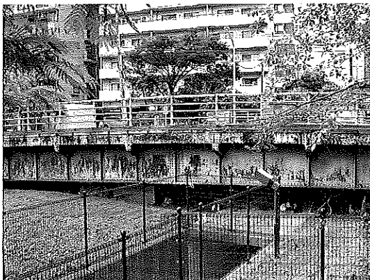
写真-1 耐荷性能確認橋梁（腐食）外観
