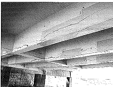
写真-3 塩害を受けたコンクリート橋
