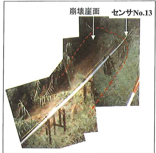
写真-4 崩壊面の状況
