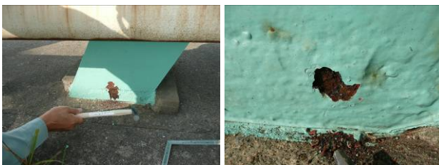
写真-8 塗膜下の腐食
