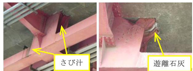
写真-2 床版下面からの外観調査結果
