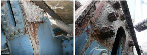
写真-13 埋設部腐食状況
