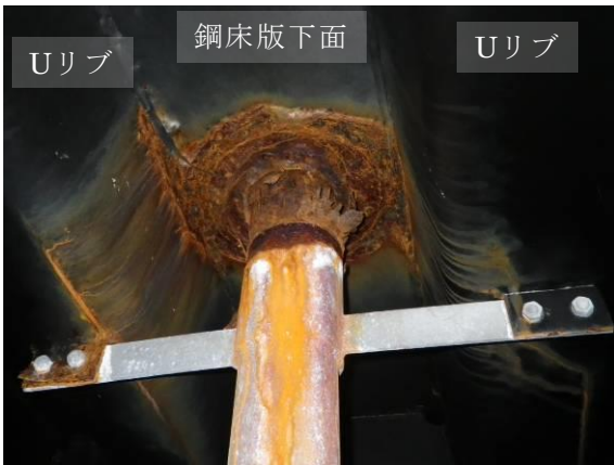
写真-4 排水桝（鋼床版下面）の損傷
