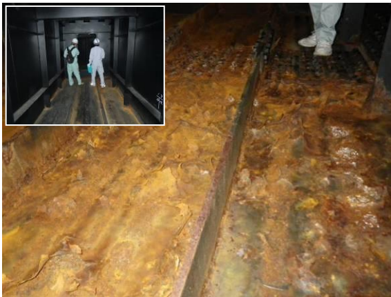
写真-5 箱桁内部の損傷（左上は健全部）
