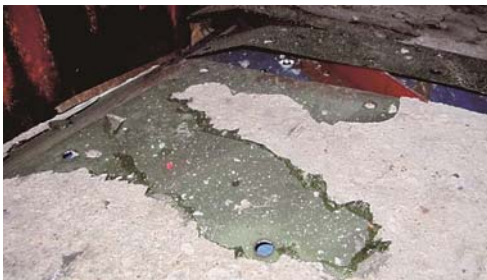
写真-4 取り外した底鋼板（床版と接触面側）
