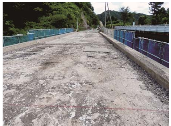
写真-1 床版損傷状態の全容
