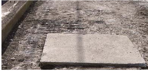
写真-2 鉄筋の露出状況
