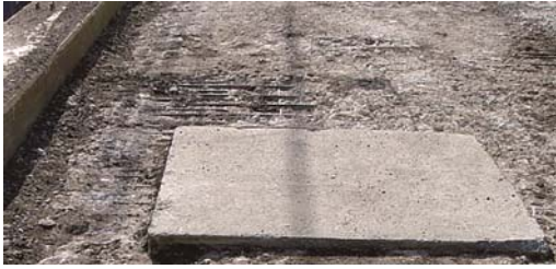
写真-2 鉄筋の露出状況
