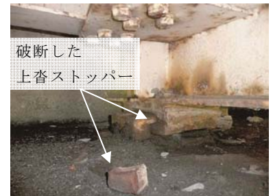
写真-2 支承の損傷
