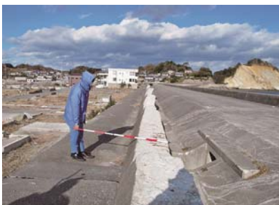
図-11 破壊されたパラペット
