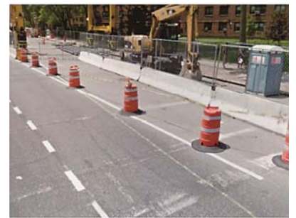
写真-2 緩衝施設の設置例
