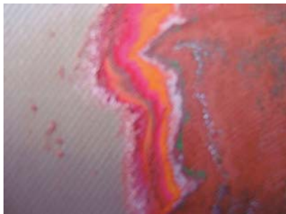
写真-1 10数の塗膜層となっている塗膜
