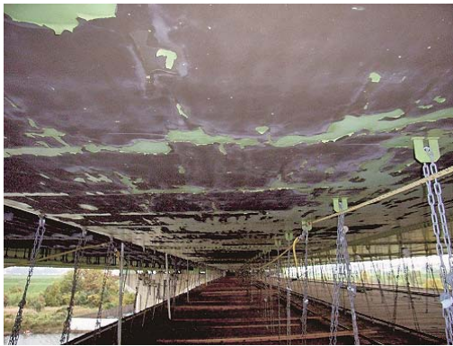
写真-2 塗膜はがれの状況
