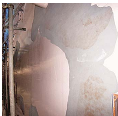
写真-1 塗膜はがれの状況
