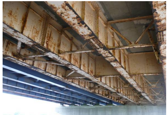
写真-2 上部工腐食状況
