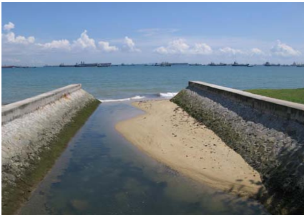
写真-2 導流堤間における堆砂状況
