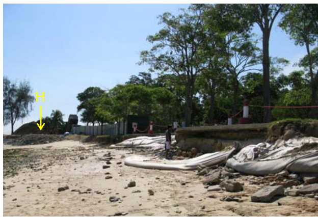
写真-12 H東側端部での浜崖形成と破壊された土嚢袋
