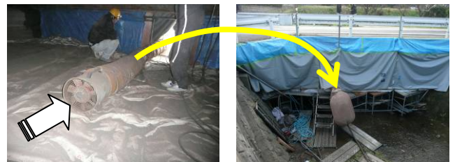
粉塵を含む空気をファンにより強制排出 粉塵濾過円筒 (布袋) により粉塵処理
