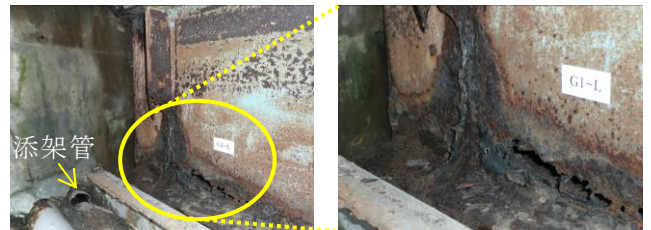
写真-2 主桁腐食
