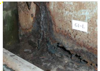
写真-3 腐食部拡大
